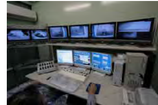
操作室(操作盤)
